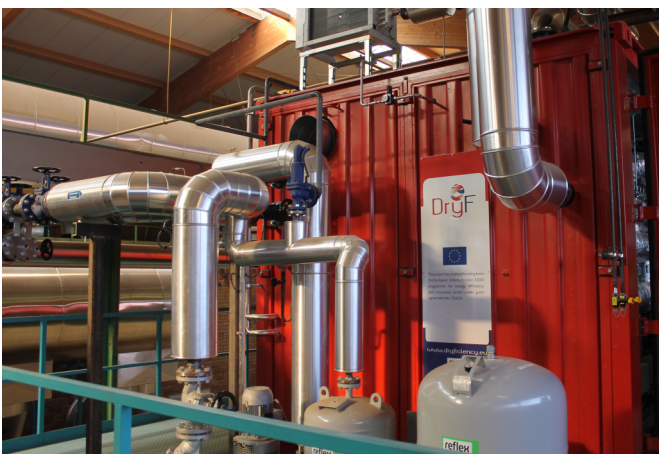
Erste industrielle Hochtemperatur-Wärmepumpe bei der Wienerberger Österreich GmbH am Standort Uttendorf in Oberösterreich im Demobetrieb © AIT / Schneeberger
