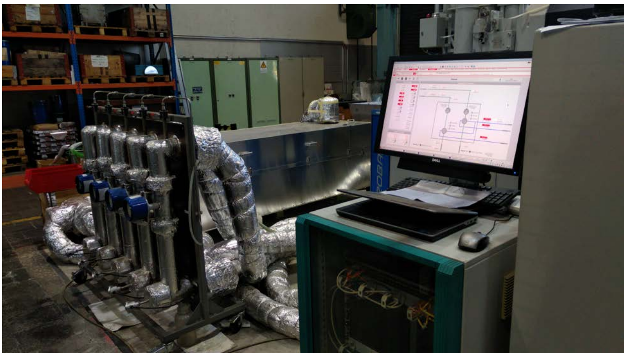
Abbildung 15: Detailaufnahme der LKR-Anlage mit dem Monitor des Leitsystems (rechts,) Anlagenmesstechnik (links), dem Polymer-PCM-Speicher (Mitte, hinten) sowie den isolierten Leitungen.
