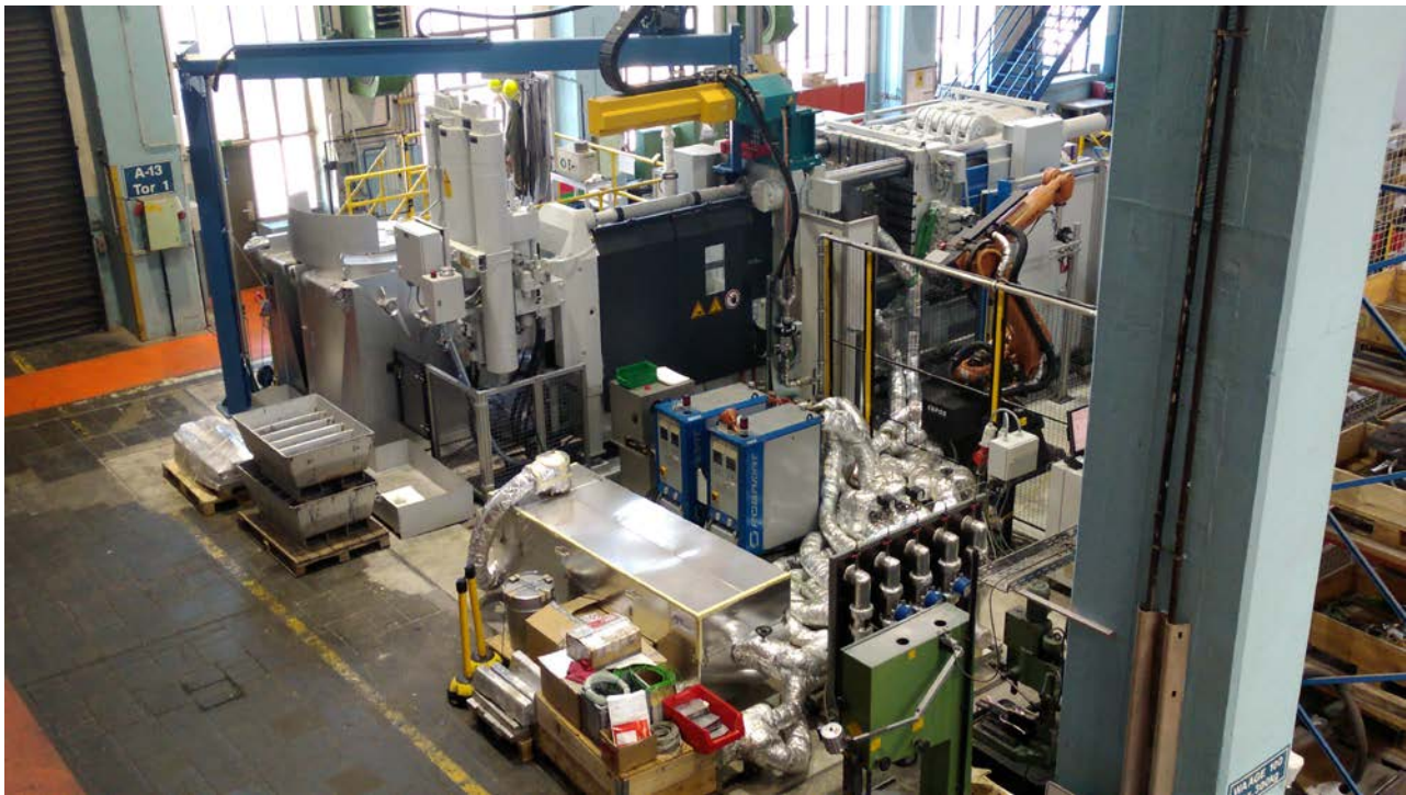
Abbildung 14: Gesamtaufnahme der LKR-Druckgussanlage mit dem Polymer-PCM-Speicher vorne, den Heiz-Kühl-Geräten (blau-weiß), Anlagenmesstechnik, Druckgussmaschine, Schmelzofen, Roboter und den isolierten Leitungen.
