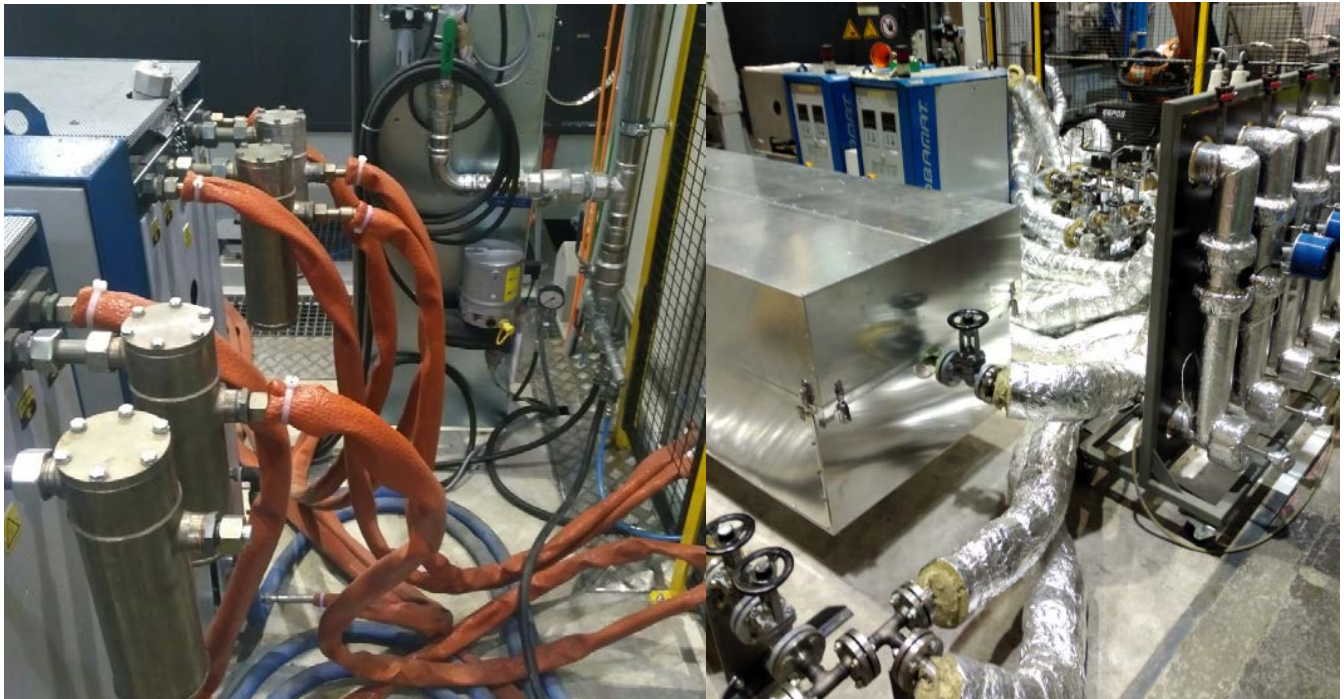
Abbildung 16: Links: Die in Gießereien oft verwendeten „roten Schläuche“ besitzen eine viel zu geringe Dämmstärke (nur wenige Millimeter) um Wärmeverluste hinreichend zu verringern. Rechts: Daher wurden bei der neuen Anlage Metallschläuche verwendet, welche vor Ort ausreichend thermisch isoliert wurden. Um eine ausreichende Dämmwirkung zu erzielen sind, je nach Temperatur des Fluids, 3-5 cm Dämmstärke notwendig.
