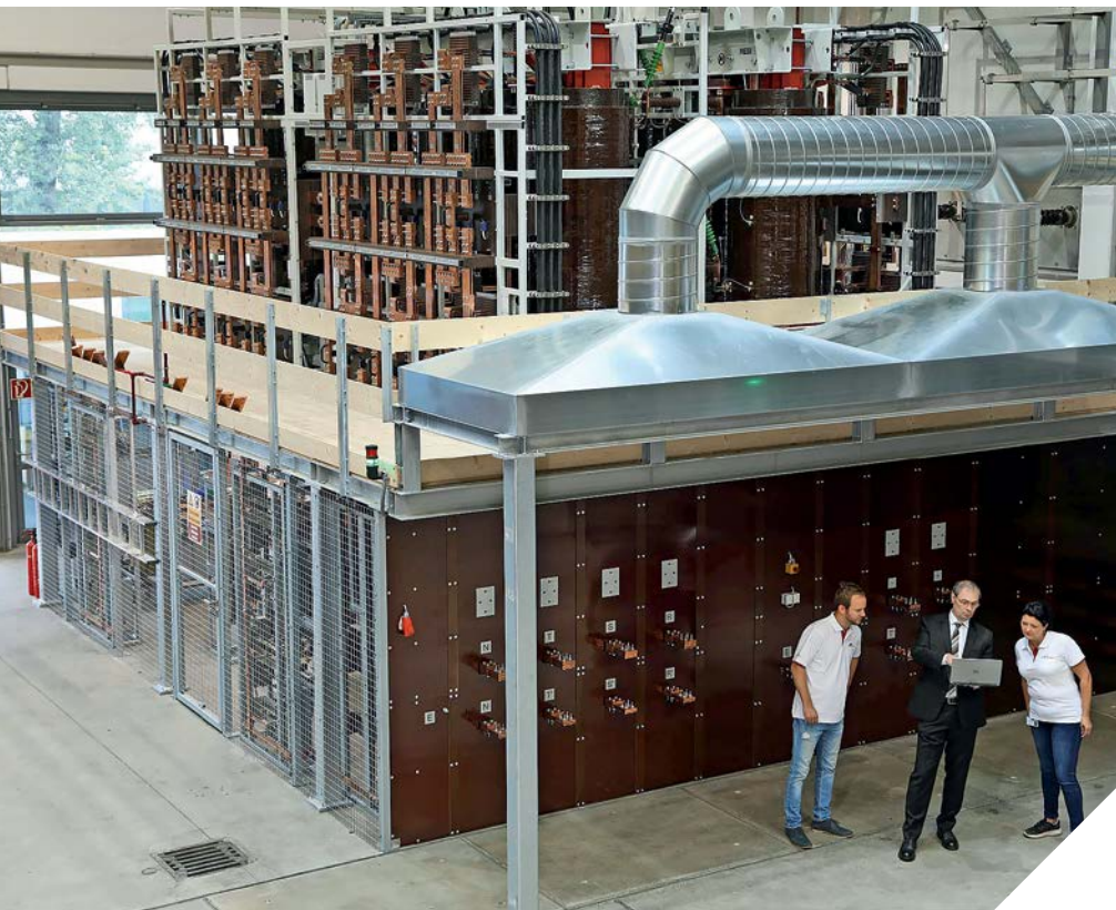
Das Schaltgerüst ist das Herzstück des DC-Labs, das aus zwei Teilen besteht: In der oberen Etage befinden sich vier Transformatoren. In der unteren Etage stehen Gleichrichter, die aus Wechselstrom Gleichstrom erzeugen. Beide Etagen sind auf sehr hohe Ströme von bis zu 80 Kiloampere und 75 Megawatt Prüfleistung ausgerichtet.
